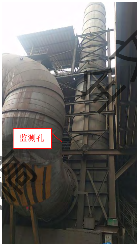
DA0212#精炼炉烟气排放口(经度: 119°44'21.524' 纬度: 26°46'4.385'高度: 38m, 内径: 2m 出口温 度: 107℃)
